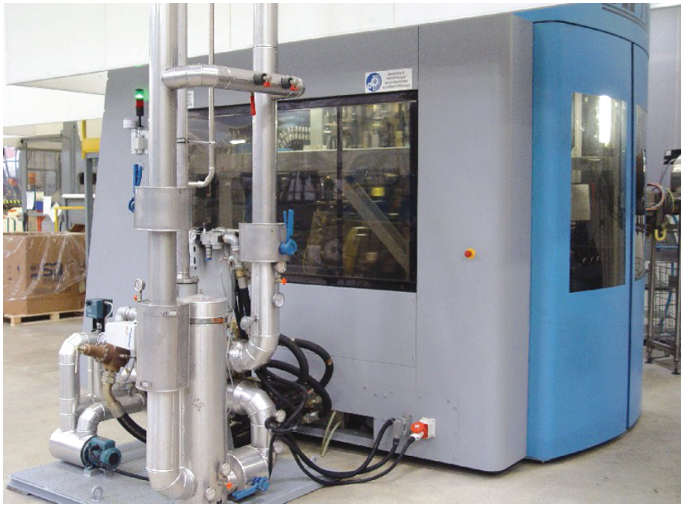
Produktionsanlage für PET-Flaschen (im Vordergrund die 28 bar Druckluftleitungen)
